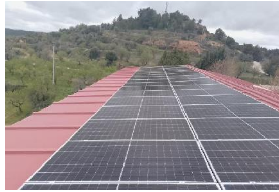
INSTALACION DE AUTOCONSUMO COLECTIVO EN FORNOLES
