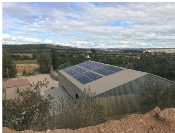
INSTALACION DE SISTEMA FOTOVOLTAICO PARA AUTOCONSUMO EN ARIDOS SEVA en Calanda
