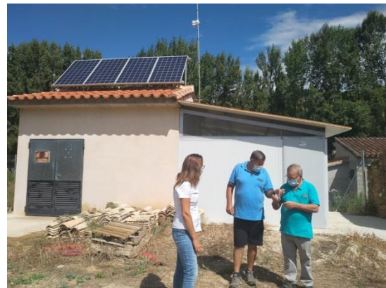
2019.10.2.023 INSTALACION FOTOVOLTAICA PARA ELEVACION DE AGUA
