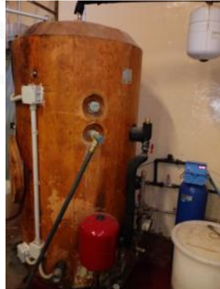
Imagen 22. Depósito de agua caliente
