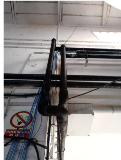
Imagen 25. Tuberías sin aislar
