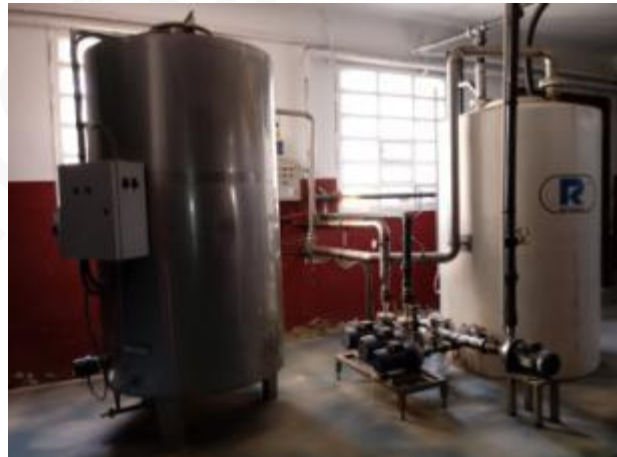
Imagen 2. Sistema de refrigeración
