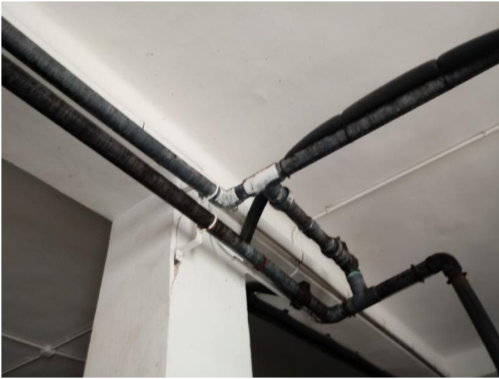
Imagen 24. Tuberías sin aislar
