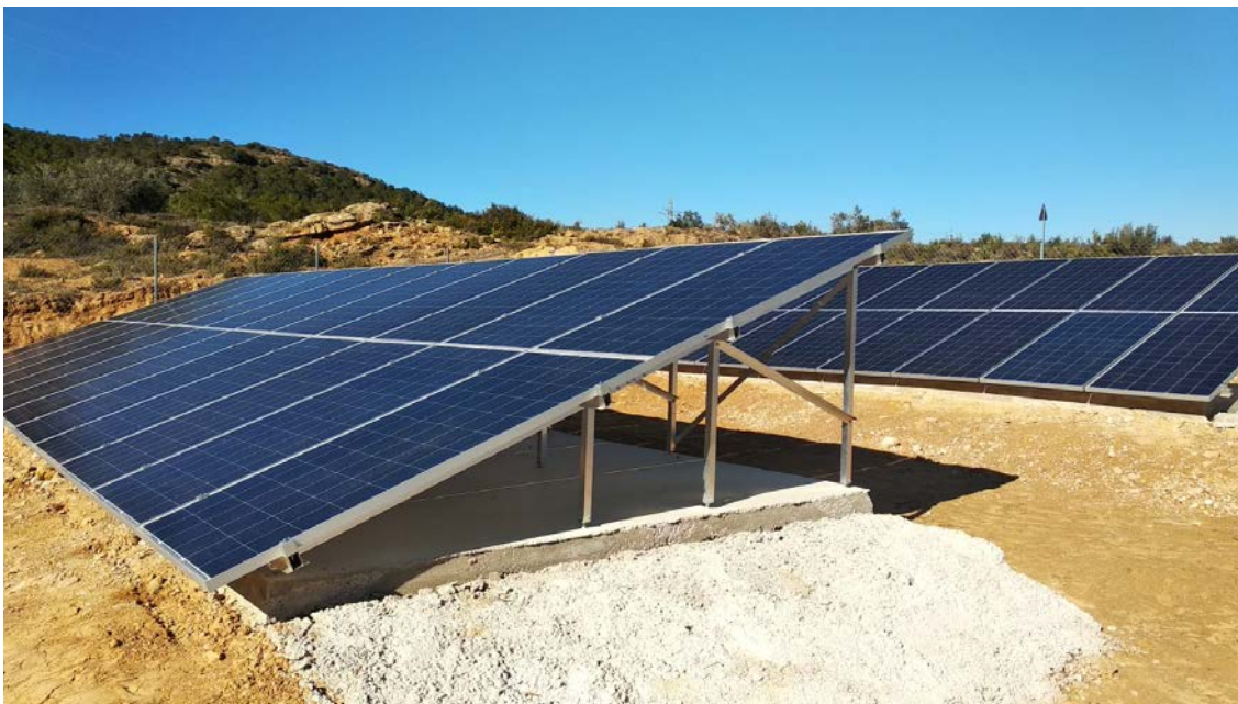
Ilustración 5. Solera de hormigón y estructura de aluminio para paneles solares
