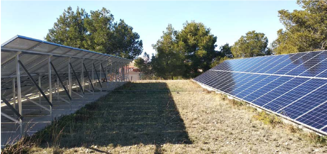
Ilustración 1. Instalación fotovoltaica sobre solera en terreno
