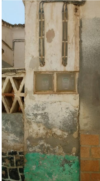
Figura 11. Contadores casas maestros
