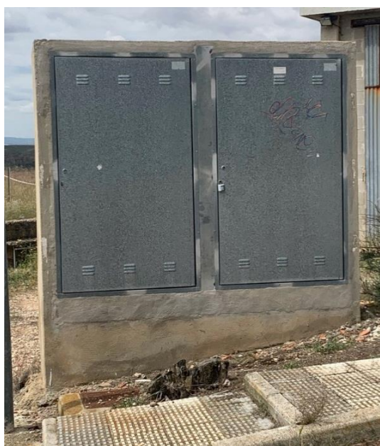
Ilustración 7. Potabilizadora de agua
