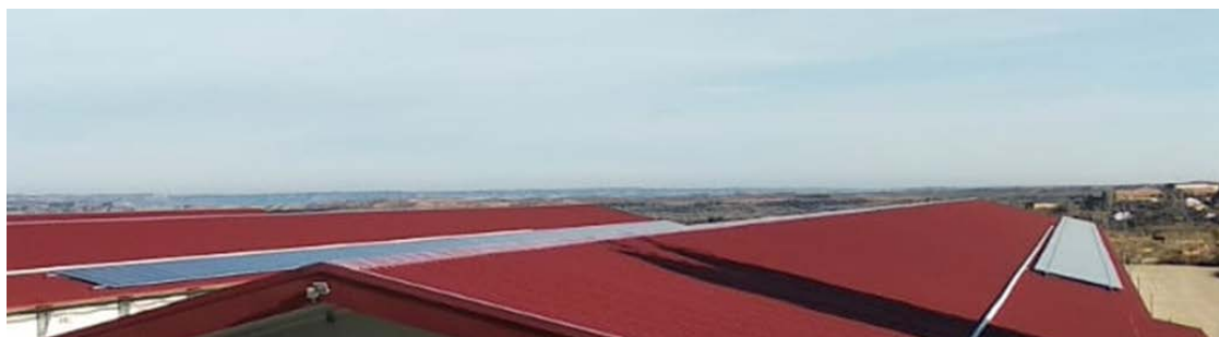
Ilustración 7. Ejemplo de instalación fotovoltaica sobre tejado
