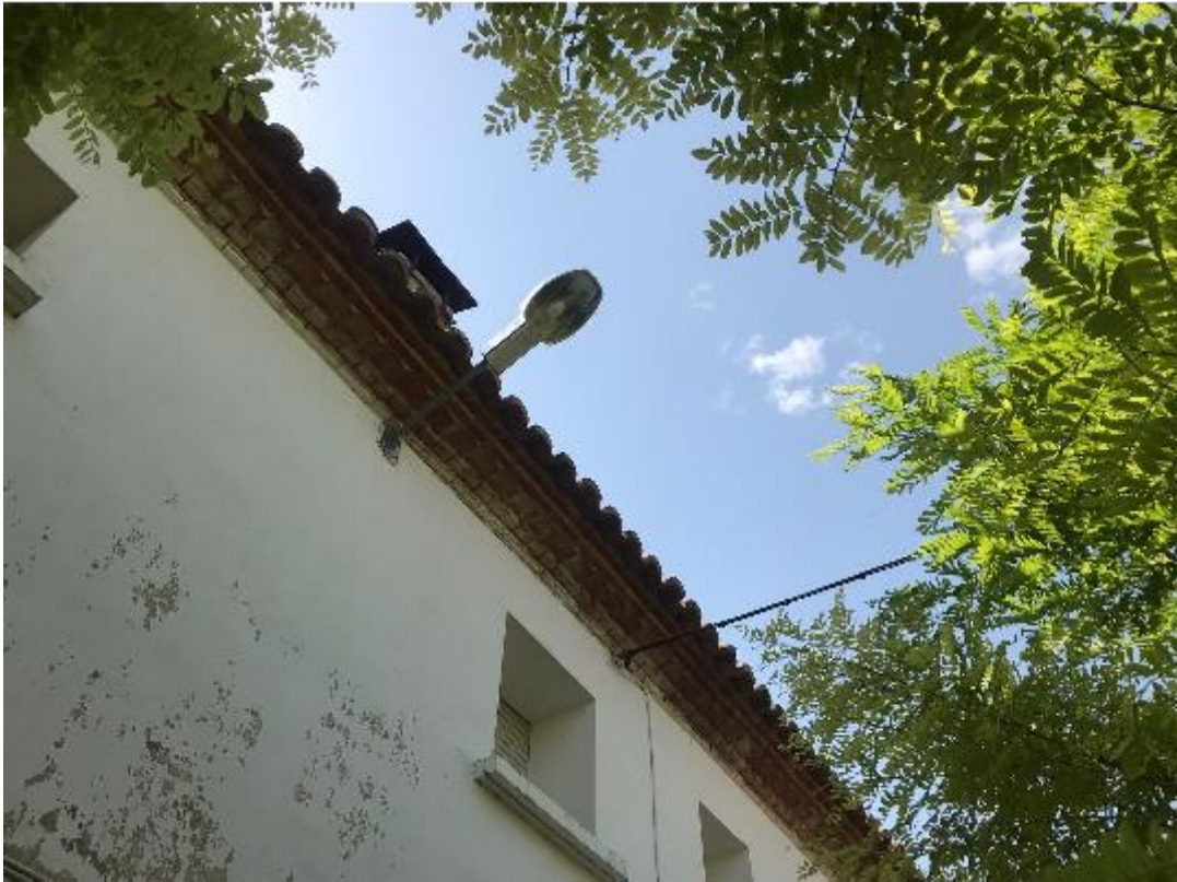
Alumbrado público, sustitución de bombillas de vapor de mercurio de 125W a 26W (únicamente sería necesario sustituir la bombilla)
