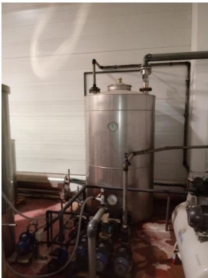
Imagen 5. Compresores equipo de frío
