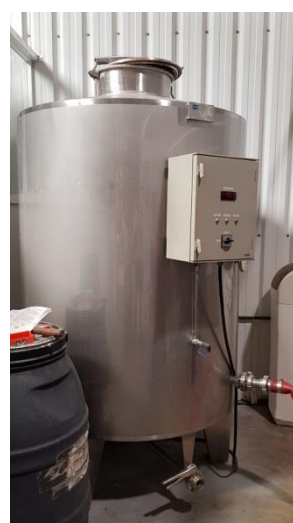
Imagen 24. Depósito agua caliente
