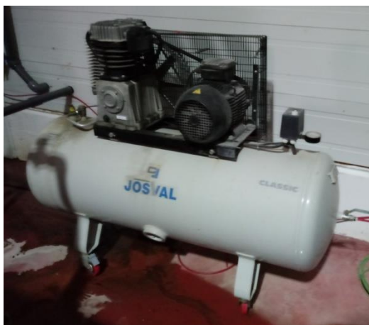
Imagen 25. Compresor de aire
