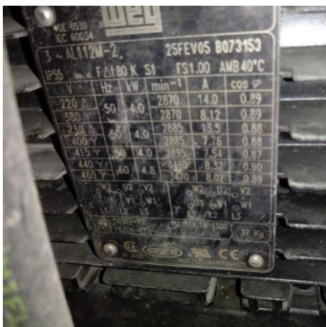
Imagen 26. Placa del compresor
