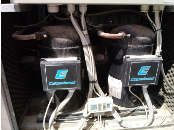
Imagen 3. Compresores equipo de frío
