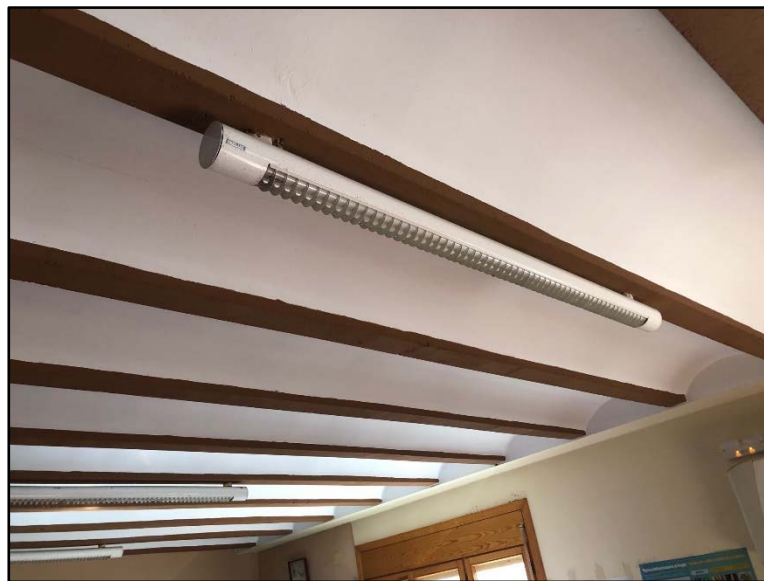
Foto 10: Iluminación existente en el bar mediante pantallas fluorescentes de 2x58 w.
