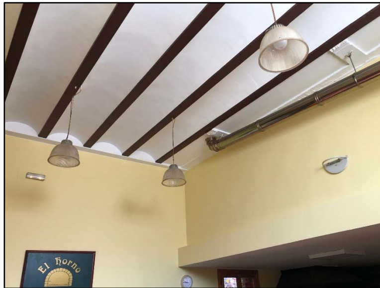
Foto 12: Iluminación existente en la zona de Horno.
