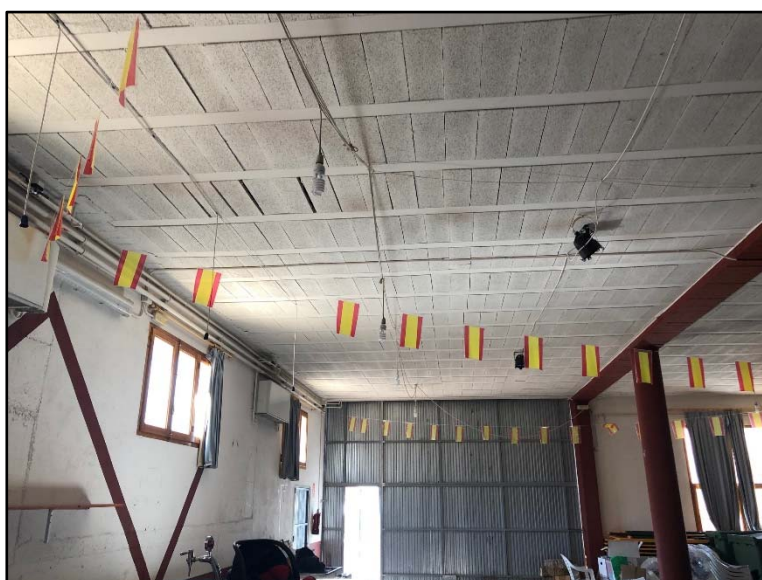
Foto 10: Imagen del estado del techo del pabellón, sin ningún tipo de aislamiento y conformado por las bovedillas que componen el forjado sin rejuntar ni revestir.
