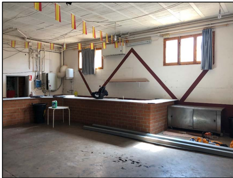
Foto 11: Iluminación existente en el Pabellón Mediante bombillas de bajo consumo sin protección mecánica y sin cumplir ningún tipo de normativa.
