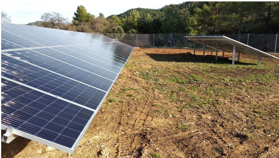
Ilustración 2. Ejemplo de instalación fotovoltaica con método inca
