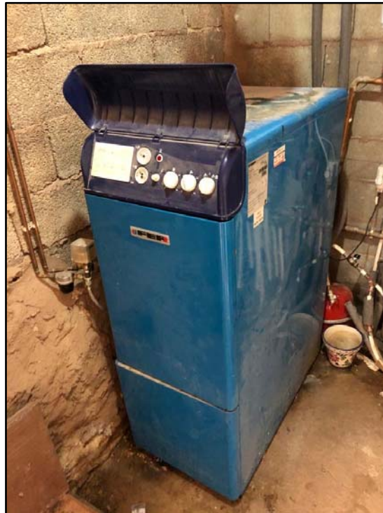
Foto 5: Caldera de gasoil existente.
