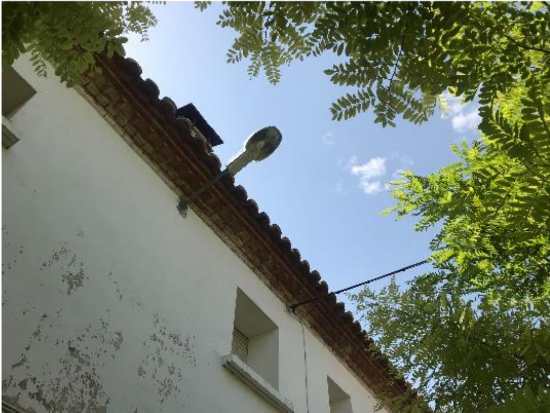
Alumbrado público, sustitución de bombillas a otras tipo LEDS.
