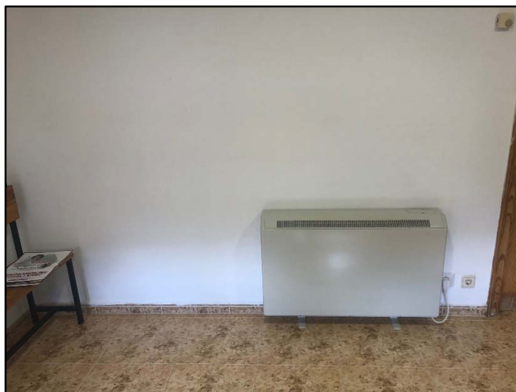
Foto 10: Sistema de calefacción existente mediante acumuladores de calor.
