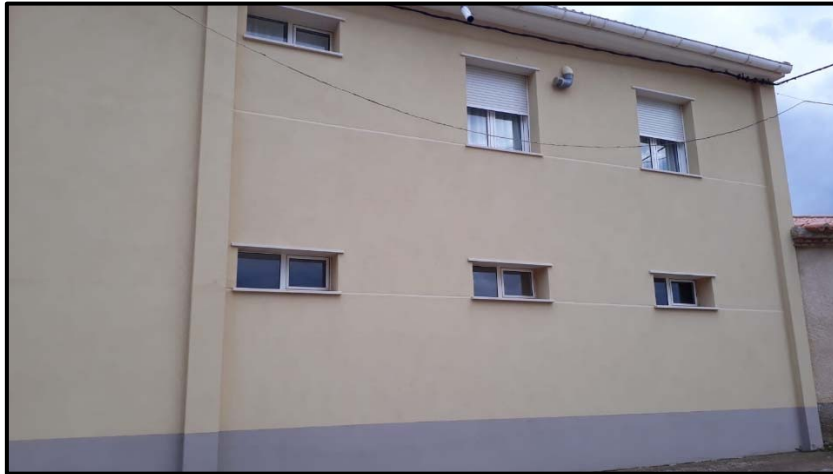
Foto 11: Foto de acabado final del aislamiento de la fachada mediante el sistema propuesto de un Edificio de las mismas características y sistema constructivo.
