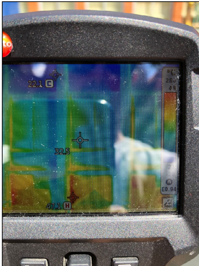
Foto 6: Termografía 2 de la fachada Sur realizada por la mañana cuando el sol incide directamente en ella.
