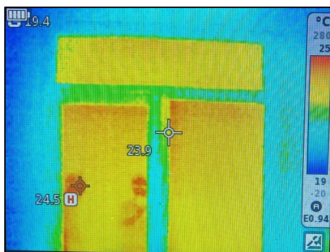
Foto 9: Imagen Termográfica una de las ventanas de la fachada sur, tomada por la tarde y sin incidencia directa del sol.
