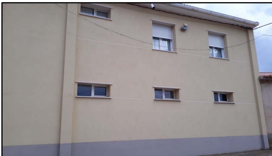
Foto 16: Foto de acabado final del aislamiento de la fachada mediante el sistema propuesto.
