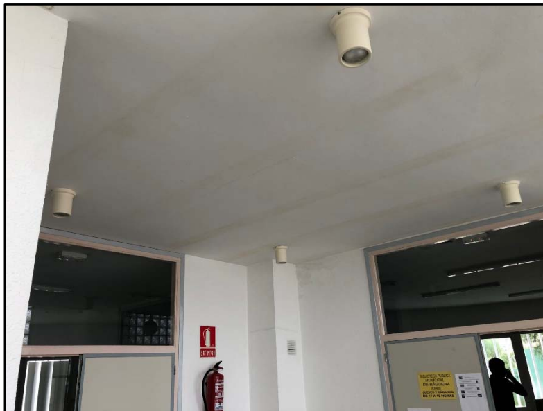
Foto 12: Fotografía de la iluminación existente en las zonas de pasillos mediante downlights de superficie de 2x26 w
