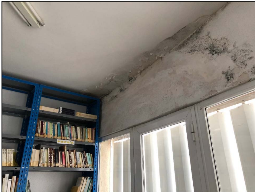
Foto 18: Foto problema de filtraciones y moho producido por la falta de ventilación.
