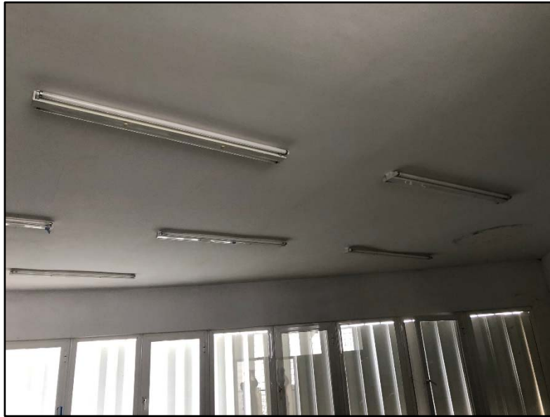
Foto 11: Fotografía de la iluminación existente en las aulas de 2x36 w de fluorescencia y sin protección mecánica.
