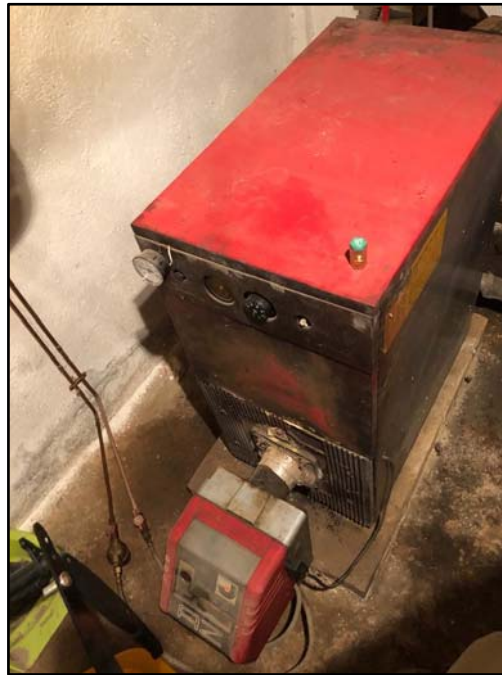
Foto 13: Caldera de gasoil de 74,2 kW.
