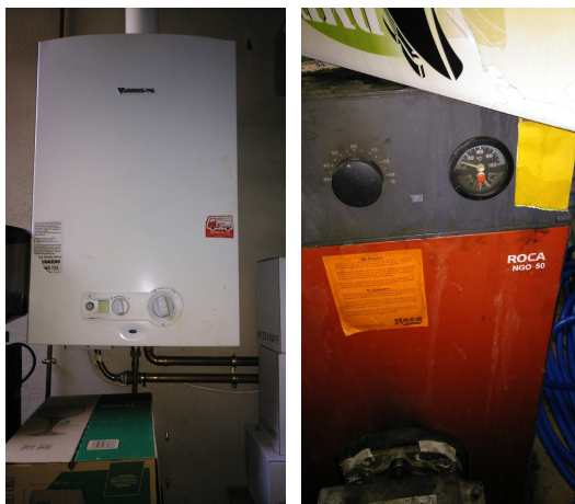
Generador de ACS (5) y de calefacción (1)
