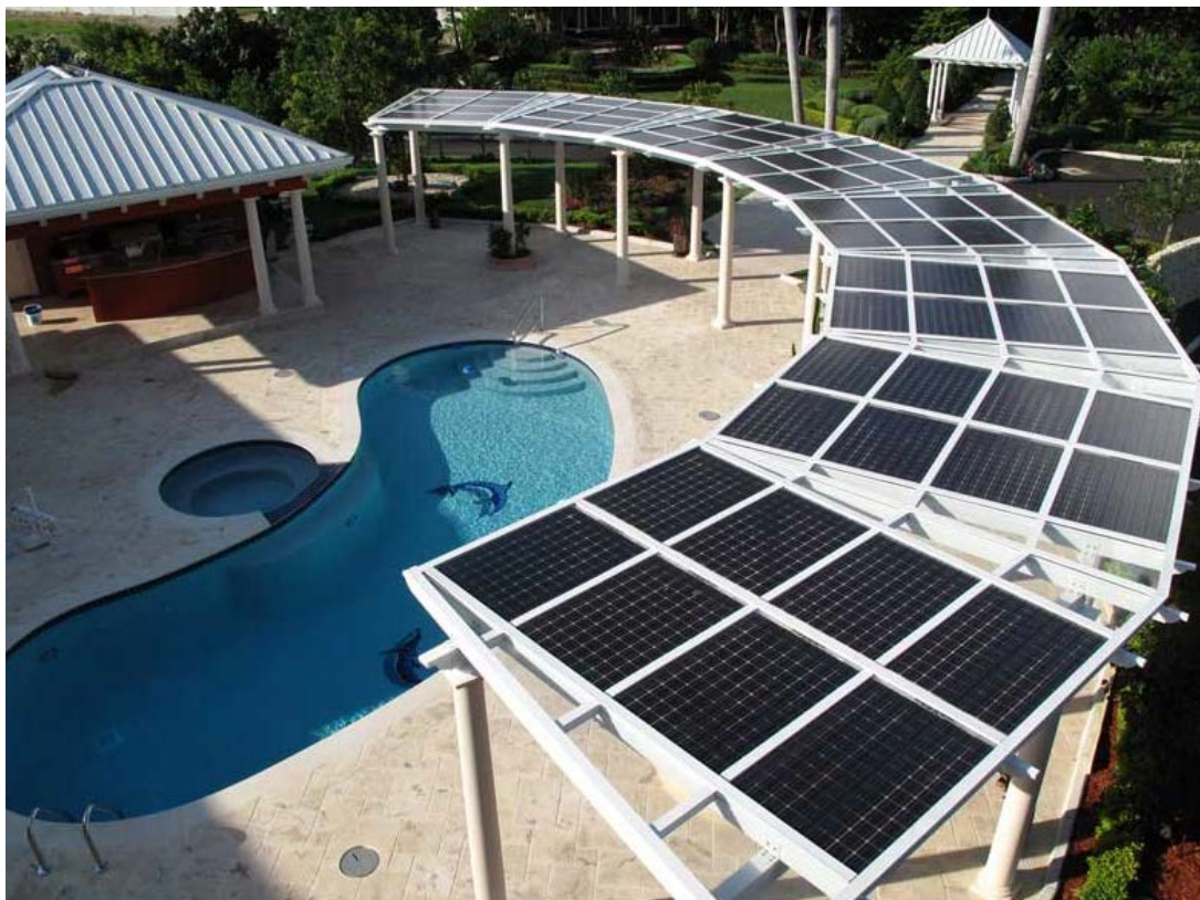
Ilustración 1. Ejemplo de instalación fotovoltaica sobre estructura para sombra en piscina
