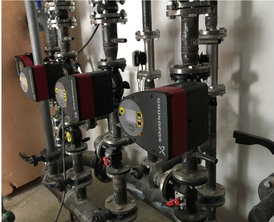
Ilustración 9. Bombas de recirculación
