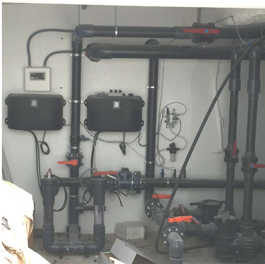
Ilustración 10. Bombas de filtrado y aparamenta
